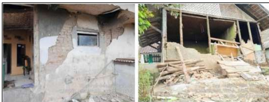
Gambar 5 Beberapa bangunan yang mengalami kerusakan akibat gempa bumi di Kecamatan Pasirwangi
